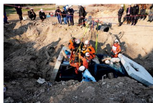
道路崩落現場での活動
