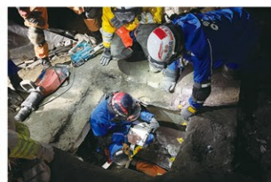
倒壊建物での活動
