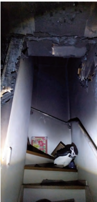
階段付近の焼き状況
