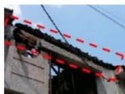
落下物の確認
