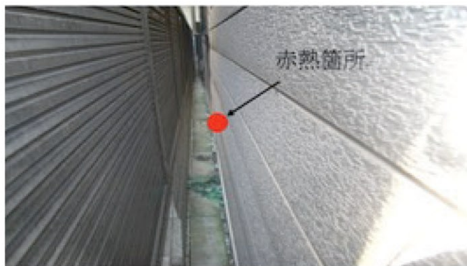
(写真1) 赤熱箇所の状況
