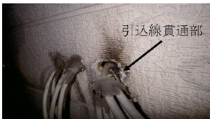
(写真2) 漏電個所の状況
