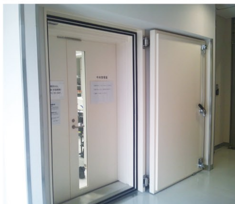
写真3 中央管理室防水扉
