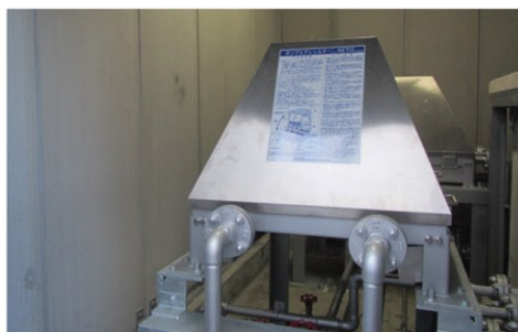
写真1 ポンプシュルター 閉
