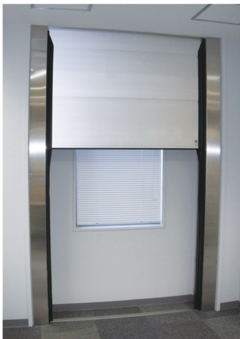
写真4 中央管理室防水シャッター
