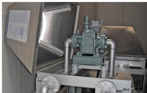
写真2 ポンプシュルター 開
