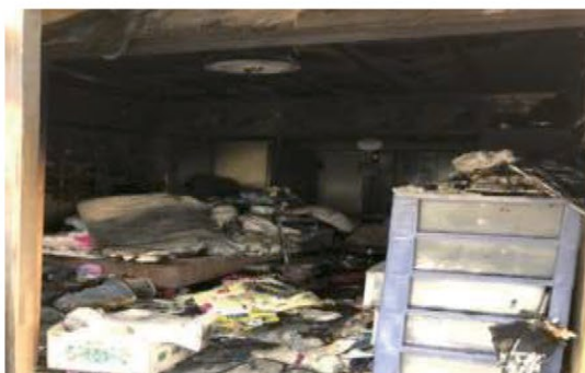
室内焼損状況
