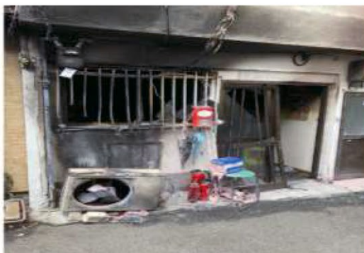
玄関の焼損状況
