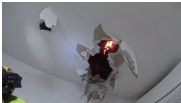
小屋裏の状況 天井を破壊すると野地板に着火していた。
