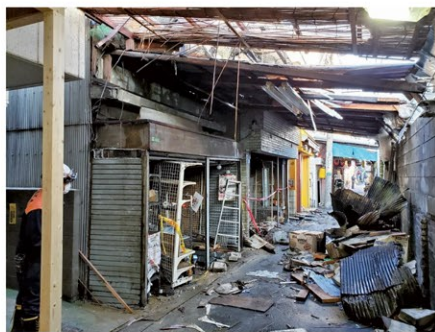
崩落が発生した東側の延焼棟(中央が崩落建物)
