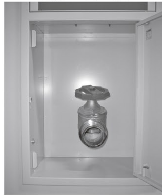
放水口(単口形)
