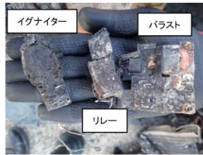
焼損したHIDユニット
